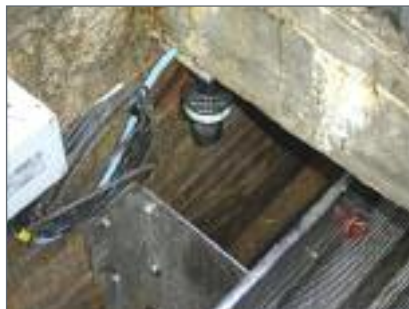
安装在 CSO 腔室内的带抗滴漏护壳的 dB3
